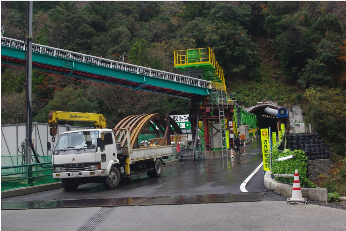
坑外設備状況
